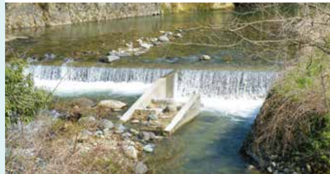
① 過去に設置された魚道が破損
